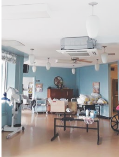
Un des climatiseurs installé au CH Marguerite-D'Youville.
